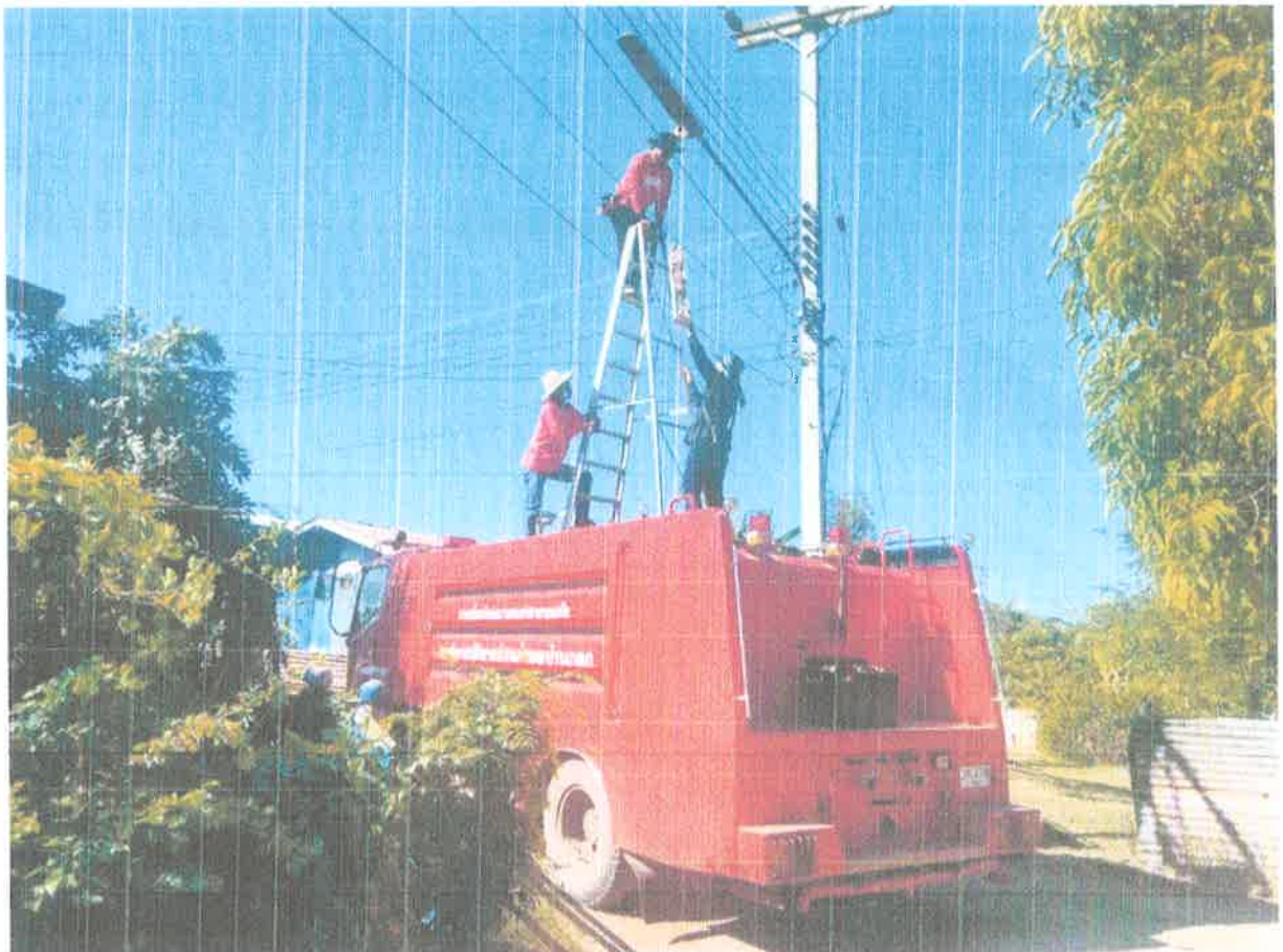
ซ่อมแซมไฟฟ้าสาธารณะบ้านสำโรงทุ่ง หมู่ที่ ๔
