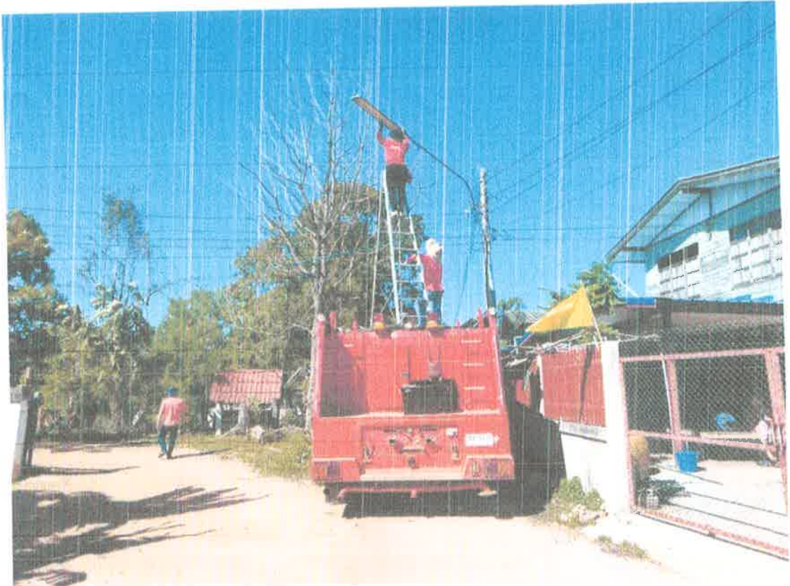
ซ่อมแซมไฟฟ้าสาธารณะบ้านสำโรงทุ่ง หมู่ที่ ๔
